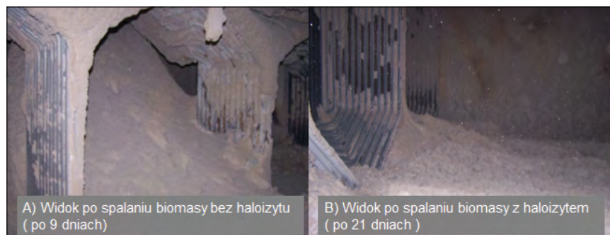
Rys. 2 Wpływ dodatku haloizytu na strukturę popiołu z przedpaleniska kotła zasilanego biomasą, wyraźnie mniejsze osiadanie popiołu na powierzchniach ogrzewalnych
