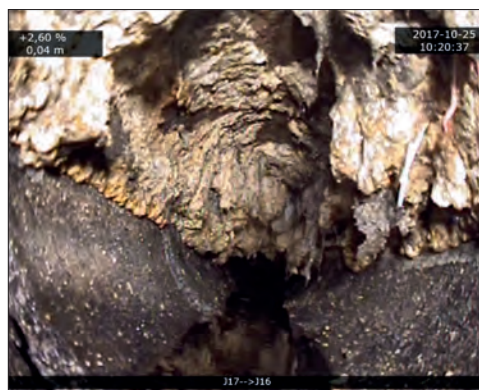
Fot. 5. Inspekcja kamerą CTV – zalegający tłuszcz. Pic. 5. CCTV inspection – residual fat.
