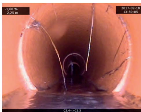
Fot. 4. Inspekcja kamerą CTV – wrastający korzeń. Pic. 4. CCTV inspection – ingrown root.
