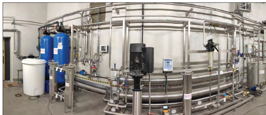
Rys. 5 Stacja RO przygotowania wody zdemineralizowanej do celów zasilania kotłowni pracującej w układzie kogeneracji. Na pierwszym planie widoczna dwustopniowa instalacja odwróconej osmozy z pompą ciśnieniową. Po lewej stronie widoczne kolumny zmiękczacza, wykorzystywane w przypadku awaryjnego zasilania RO wodą odżelazioną twardą
