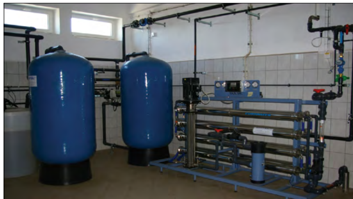
Rys. 4 Instalacja RO dla celów kotłowych. Woda jest wstępnie uzdatniana w filtrze węglowym, a następnie zmiękczaczu zanim wpłynie do instalacji membranowej
