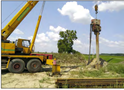
Fot. 3. Wykonywanie ścianek szczelnych metodą wibracyjną przy użyciu wibromłota. Źródło: fot. Tolos Pic. 3. Sheet piling using the vibration method with the use of a vibrator. Source: photo by Tolos
