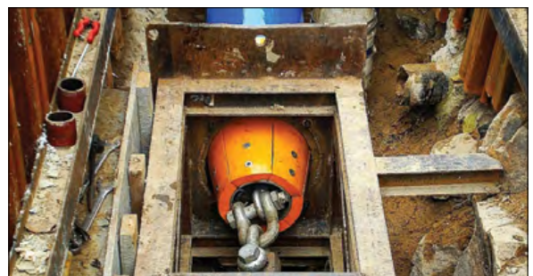
Fot. 1. Wykonanie renowacji w technologii Swageliningu (źródło: PW Trenchless Construction Inc.) Pic. 1. Renovation using Swagelining technology (source: PW Trenchless Construction Inc.)
