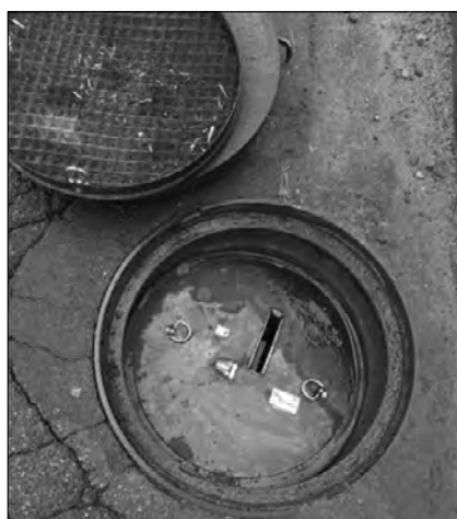
Rys. 3 Urządzenie zamontowane w studni kanalizacyjnej Fig. 3 Measure device mounted in sewage well
