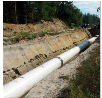
Fot. 3. Rura gazociągu ułożona w wykopie Pic. 3. Gas pipeline laid in a trench
