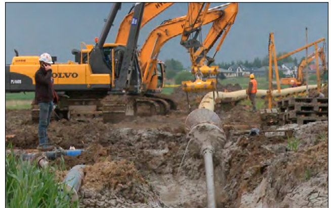
Fot. 5. II etap montażu - rozwieranie z wciąganiem rury gazowej w metodzie przewiertu HDD Pic. 5. Stage II of the assembly - reaming with pulling of the gas pipe in the HDD drilling method
