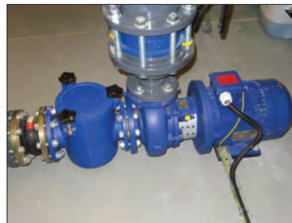
Fot. 14. Pozioma pompa wody basenowej
