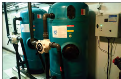
Fot. 9 Filtry ciśnieniowe z zaworami sześci drogowymi
