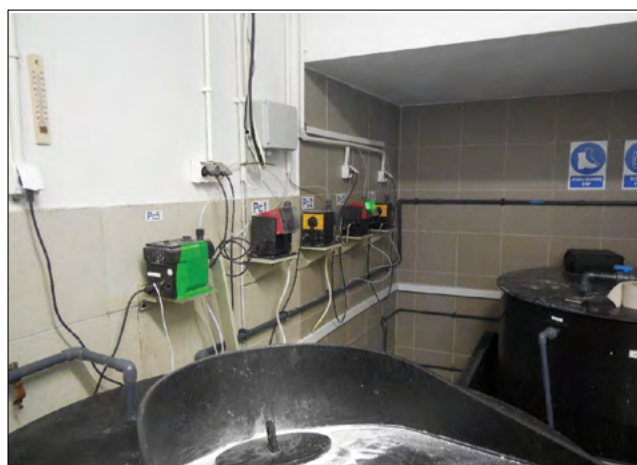
Fot. 7. Magazyn podchlorynu sodu – zbiornik solanki i pompy dozujące
