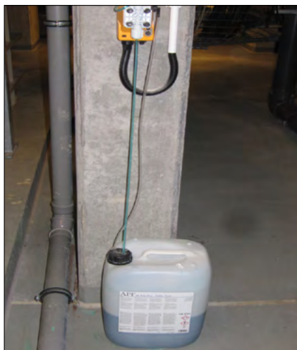
Fot. 17. Zbiorniki i pompa dozująca APF
