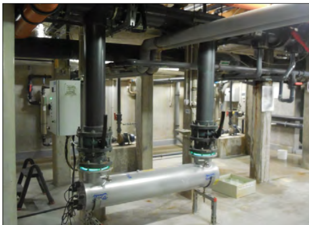
Fot. 3. Lampa UV w zabudowie poziomej
