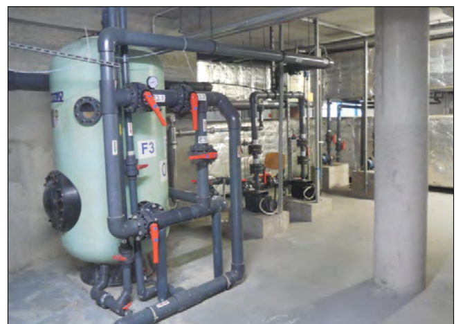
Fot.2. Pompy i filtr wody dla obiegu basenu rekreacyjnego
