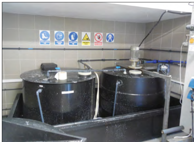
Fot. 6. Magazyn – zbiorniki podchlorynu sodu
