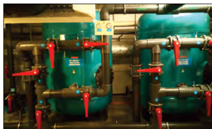
Fot. 10. Filtry ciśnieniowe z zespołem zaworów kłapowych
