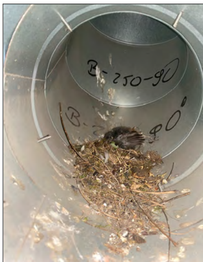
Rys. 5. Gniazdo w przewodzie wentylacyjnym wywiewnym od strony wyrzutni. Fig. 5. The nest in the exhaust air duct on the side of the extract air.
