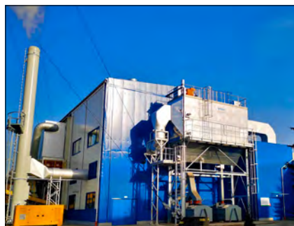
Fotografia 9. Budynek kotłowni biomasowej po instalacji kotła Photo 9. Biomass boiler room after boiler installation
