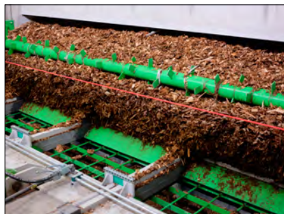
Fotografia 4. Element instalacji biomasowej - rozrzutnik paliwa Photo 4. Biomass installation component - fuel spreader
