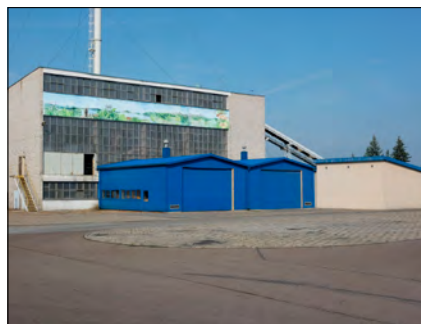
Fotografia 8. Budynek kotłowni przed rozbiórką i montażem kotła biomasowego Photo 8. Boiler house before demolition and installation of biomass boiler
