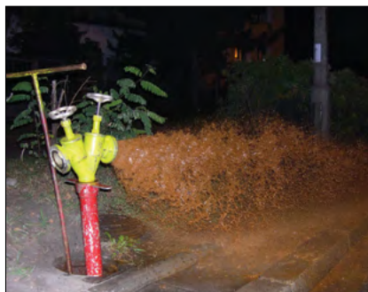
Rys. 1. Wtórne zanieczyszczenie wody w sieci wodociągowej w efekcie niewłaściwego uruchomienia hydrantu [36]
