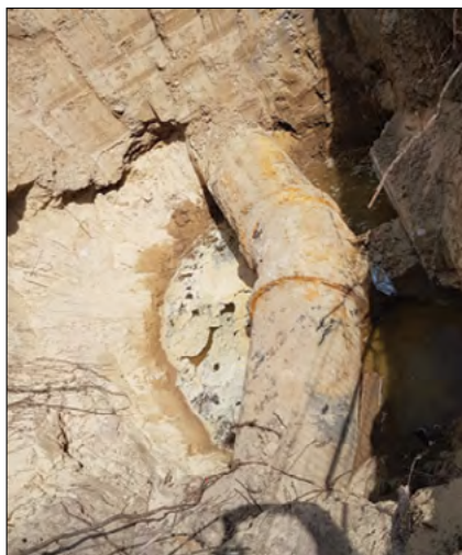
Fot.1. Rurociąg na załamaniu 30°. Stan przed renowacją Pic. 1. Pipeline at a 30 ° bend. Condition before renovation
