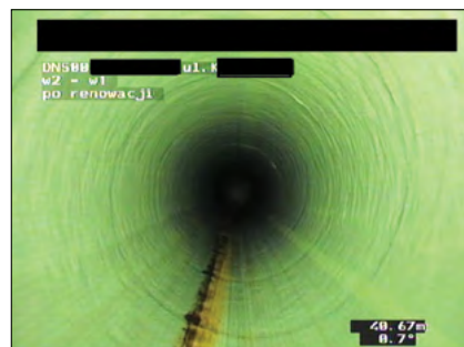
Fot. 13: Inspekcja CCTV rurociągu DN500 stalowego – stan po renowacji Pic. 13: CCTV inspection of the steel pipeline DN500 – condition after renovation
