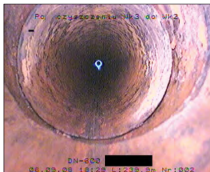
Fot.17. Przesunięcia osiowe rur Pic.17. Axial displacement of the pipes
