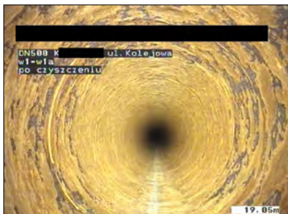
Fot. 10. Inspekcja CCTV rurociągu DN500 stalowego – stan po oczyszczeniu Pic. 10. CCTV inspection of the steel pipeline DN500 – condition after cleaning
