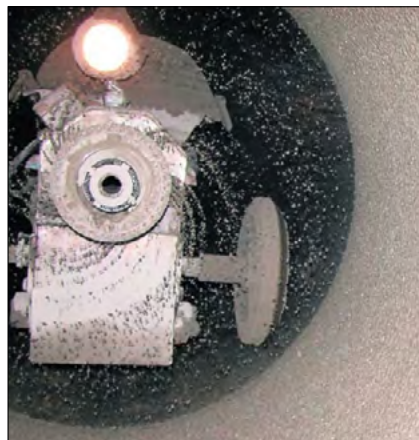
Fot.19. Głowica w trakcie natryskiwania rury zaprawą cementową Pic. 19. The head is spraying the pipe with cement mortar
