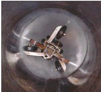
Fot. 8. Czyszczenie hydrodynamiczne metodą VACUJET – do połysku metalicznego Pic. 8. Hydrodynamic cleaning with the VACUJET method – to a metallic shine
