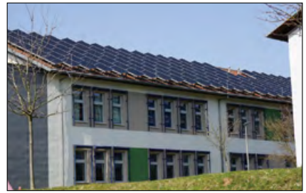
Rys. 8. Przykład instalacji fotowoltaicznej w układzie „południe”, zlokalizowanej na dachu jednego z budynków w kampusie, fot. K. Kurtz-Orecka Fig. 8. An example of a photovoltaic installation in the “South” layout, located on the roof of one of the buildings on the campus, photo by K. Kurtz-Orecka
