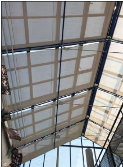
Rys. 3. System markiz wewnętrznych ograniczających słoneczne zyski ciepła w okresie ciepłym, fot. K. Kurtz-Orecka Fig. 3. System of internal awnings limiting solar heat gains in the warm season, photo by K. Kurtz-Orecka
