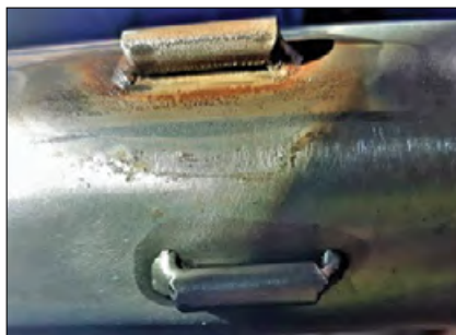
Fig. 4. Rusted and clean spacers after 20 days of hot water flow in the installation Rys. 4. Zardzewiały oraz czysty, metaliczny element dystansowy po 20 dniach przepływu gorącej wody w instalacji
