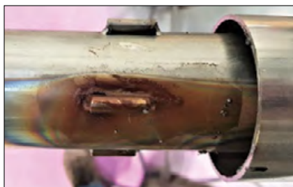
Fig. 3. The spacer at the side rusted at its bottom and its upper surface Rys. 3. Boczny element dystansowy pokryty rdzą pomiędzy spoinami oraz na całej powierzchni
