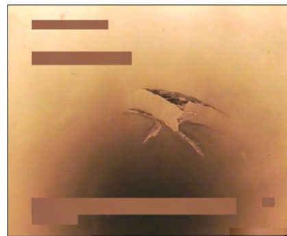
Rys.6. Odrywanie się wewnętrznej warstwy rury od pozostałych (zdjęcie własne wykonane kamerą kanalizacyjną) Fig. 6. Detachment of the inner layer of pipe from the others (own photo taken with a sewage camera)
