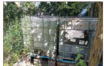
Fot. 2. Instalacja ujmowania i gromadzenia wody opadowej
