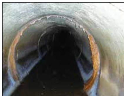
Rys.6. Wnętrze kanału żelbetowego o średnicy 1800 mm [14] Fig.6. The interior of a reinforced concrete sewer with a diameter of 1800 mm [14]
