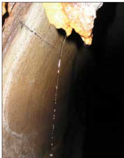
Rys.7. Wyciek wody z nieszczelnego złącza [14] Fig.7. Water leakage from a leaky joint [14]
