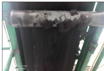
Rysunek 1 Oblodzona rolka taśmociągu odzuzłania w czasie normalnej pracy Fig. 1 Icy roller of the deslagging conveyor during normal operation
