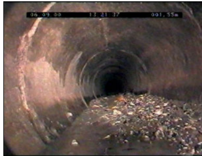
Rys. 1. Osad ruchomy w przewodzie kanalizacyjnym zakwalifikowany do IV kategorii prawdopodobieństwa awarii, 35 \leq z_p < 50\% , (zdjęcie własne) Fig. 1. Mobile deposit in sewer classified to IV category of failure probability, 35 \leq z_p < 50\% , (own photo)
