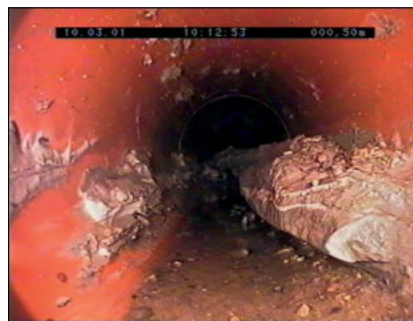
Rys. 2. Osad stały w przewodach kanalizacyjnych zakwalifikowany do II kategorii prawdopodobieństwa awarii, 5 \leq z_s < 20\% (zdjęcie własne) Fig. 2. Solid deposit in sewer classified to II category of failure probability, 5 \leq z_s < 20\% (own photo)
