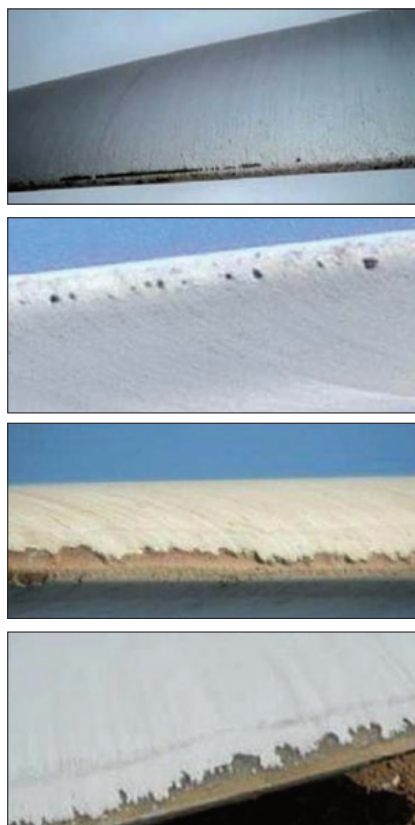
Rysunek 5. Postęp erozji w czasie, po 10 latach erozja osiąga 4 poziomy uszkodzenia, co przekłada się na około 2% straty w rocznej produkcji energii elektrycznej [13]. Grafika zaczerpnięta z [16]
