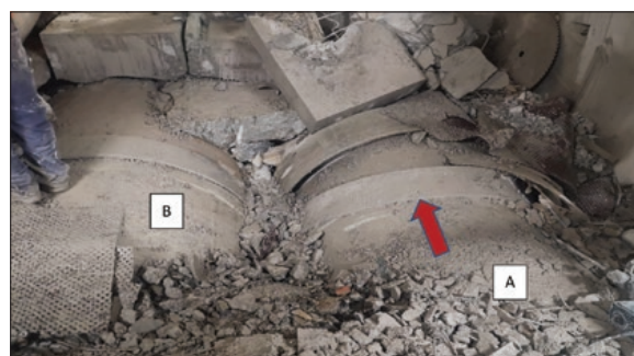
Rys. 4. Widok na uszkodzone rury w tunelu po odpompowaniu ścieków i usunięciu posadzki betonowej (30 sierpnia 2019 r.) (źródło fot.: MPWiK SA Warszawa) Fig. 4. View of the damaged pipes in the tunnel after pumping out of wastewater and removing concrete deck. (August 30, 2019 r.) (source fot.: MPWiK SA Waterworks Warsaw)
