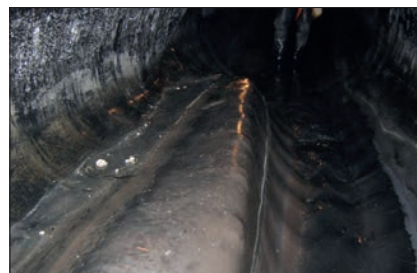
Rys. 5. Utrata stateczności przez rurę PE-HD o średnicy 1600 mm (zdjęcie własne) Fig. 5. Loss of stability through a PE-HD pipe with a diameter of 1600 mm (own photo)
