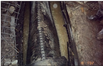
Rys. 7. Utrata stateczności przez rurę PE-HD o średnicy 1600 mm (zdjęcie własne) Fig. 7. Loss of stability through a PE-HD pipe with a diameter of 1600 mm (own photo)
