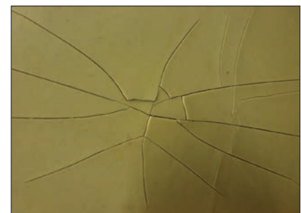
Rys. 11. Pęknięcie tzw. złożone wewnętrznej warstwy żywicznej wykryte 14 miesięcy po przekazaniu rur do eksploatacji (zdjęcie własne) [18] Fig. 11. The crack of the so-called deposits of the inner resin layer detected 14 months after the pipes were commissioned (own photo) [18]
