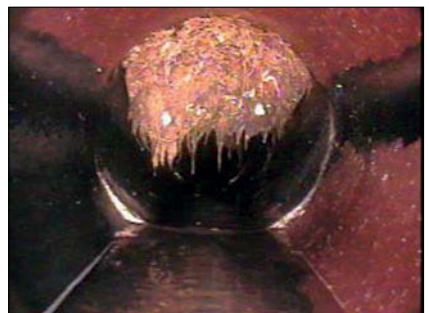
Rys. 5. Korzenie drzew wrastające do wnętrza kanału (zdjęcie własne) Fig. 5. Tree roots growing into the sewer (own photo)
