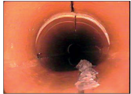
Rys. 2. Pęknięcie podłużne z przemieszczeniem rury (zdjęcie własne) Fig. 2. Longitudinal crack with pipe displacement (own photo)
